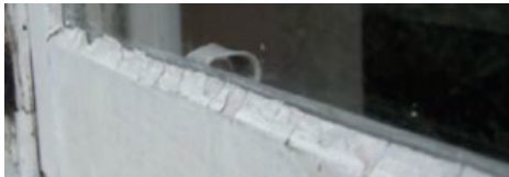
Stopverf met asbest valt in risicoklasse 2
